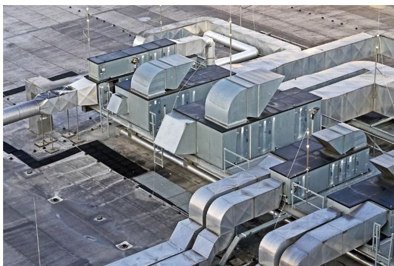
Figura 6. Sistem de ventilație pe acoperișul unei clădiri.
