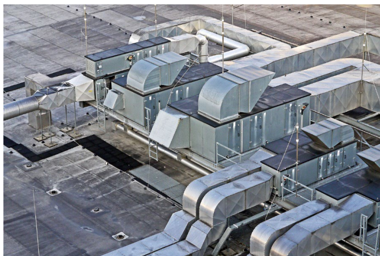
Figur 6. Ventilasjonssystem på taket av en bygning.
