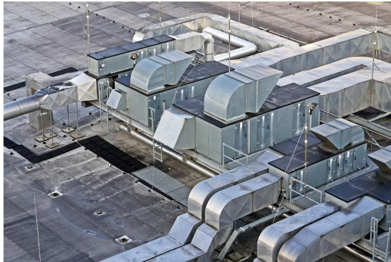
7 pav. Ventiliacijos sistema ant pastato stogo.
