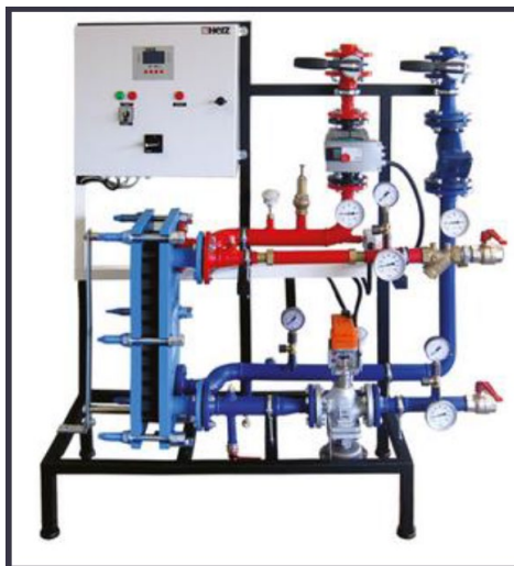
Figur 6: Varmevekslerplate i understasjon (i kjelleren i bygningen)
