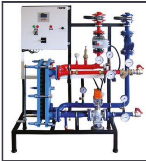
Figur 6: Varmevekslerplate i understasjon (i kjelleren i bygningen)
