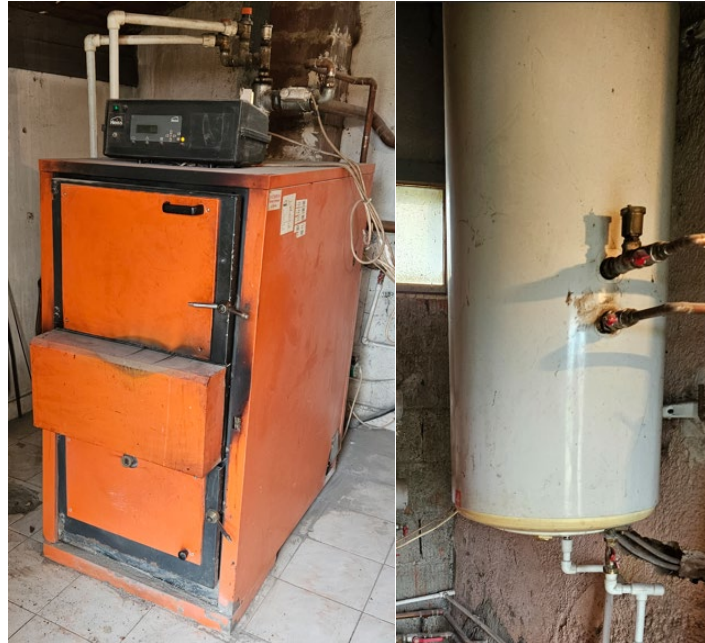
Figur 2. Skole i Romania – varmekilde
